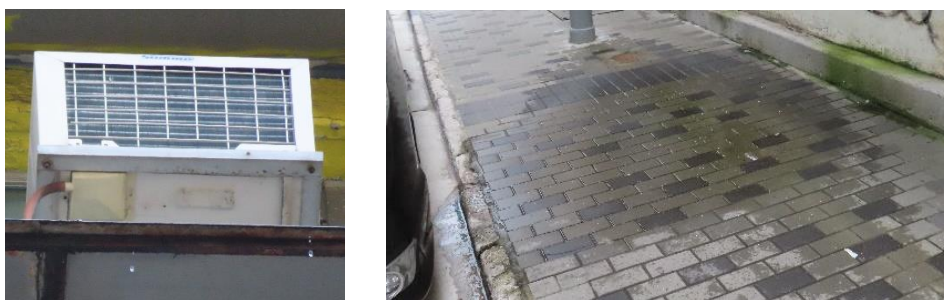
圖五及圖六：冷氣機排水膠喉接駁不良以致凝水滴濕行人路，影響環境衛生及市容
